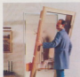
1 Собранный локот облицовки (покрытый лаком) надевается на старую коробку, при этом соблюдая расстояние по толщине (либо выходящее за нее).
